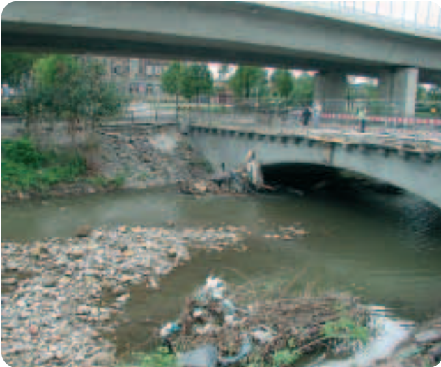
Abbildung 3-10: Unzureichender Brückenquerschnitt im aus- gebauten Trapezgerinne, Vereinigte Weißeritz, Dresden, Wernerstraße (Foto: LTV, 2002)
