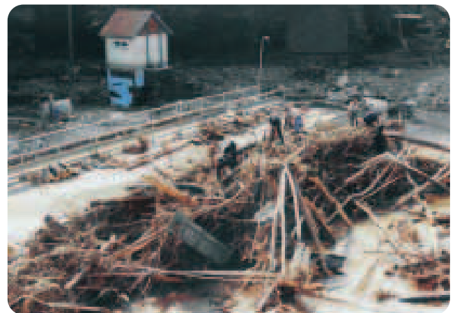
Abbildung 3-9: Verkläuste und beschädigte Müglitzbrücke, Behelfsbrücke Schlottwitz oberhalb der Mündung des Trebnitzgrundbaches (Foto: LTV, 2002)
