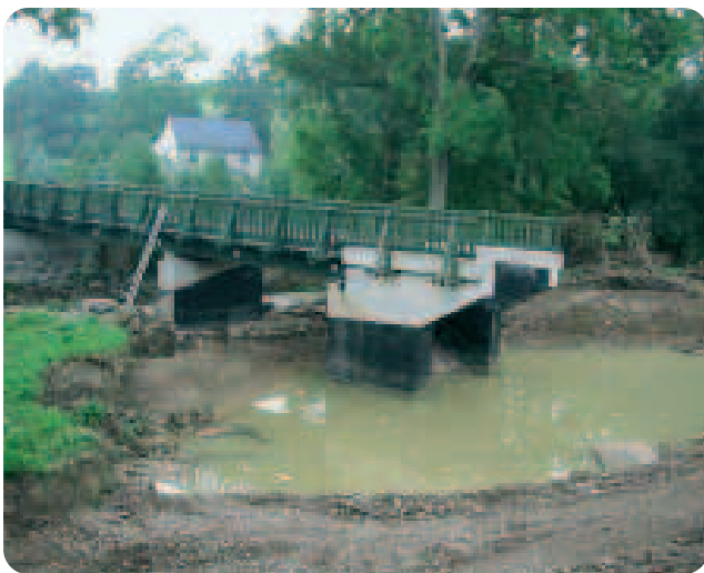
Abbildung 3-4: Vollständige Erosion der rechten Auffahrt der Brücke zur Kläranlage Miltitz an der Triebisch (Foto: LTV, 2002)
