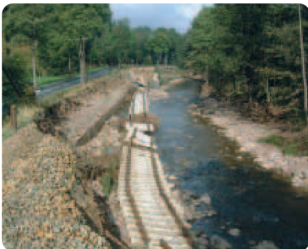
Abbildung 3-6: Vollständige Erosion des Bahndammes im Müglitztal (Beachtenswert ist die freigelegte alte Stützmauer, die dem Fluss früher ein breiteres Bett einräumte.) (Foto: LTV, 2002)
