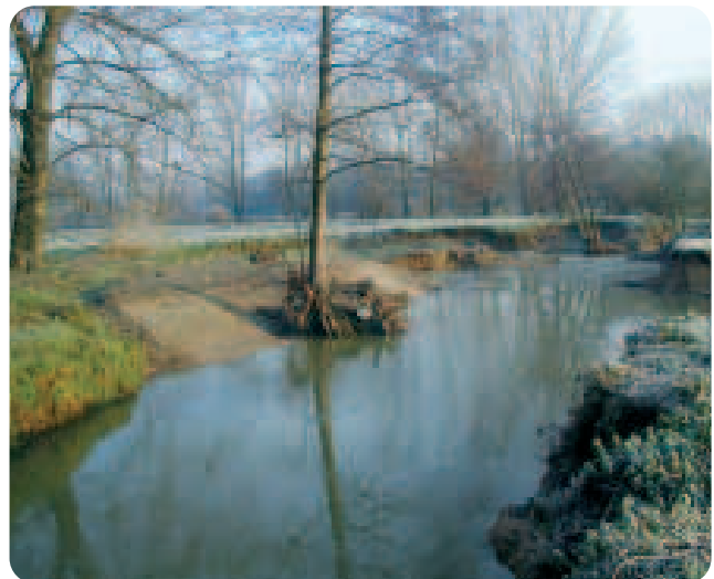
Abbildung 3-8: Erosion und Gewässerbettverlagerung am Ketzerbach unterhalb Mertitz (Foto: LTV, 2002)
